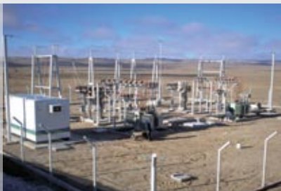
Estaciones Transformadoras de Plantas de Inyección de Agua Salada. Cerro Dragón. Chubut - Pan American Energy
