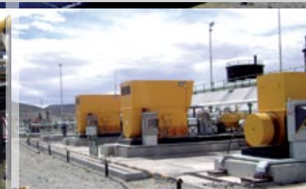
Planta de Inyección de Agua Salada Zorro II. Cerro Dragón, Chubut - PAN AMERICAN ENERGY.
