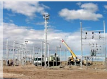
Estación Transformadora N 16 y Koluel Kaike. Santa Cruz - YPF.
