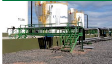
Batería ET 8. El Tapial. Neuquén CHEVRON SAN JORGE S.R.L.
