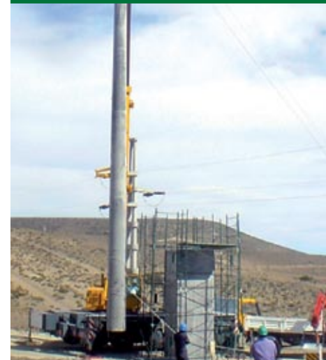
Línea Alta Tensión 132 kV Meseta 14 CG. Cerro Dragón, Chubut - PAN AMERICAN ENERGY.
