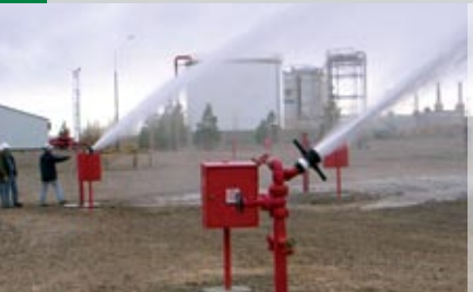
Planta de Tratamiento Las Heras 3. Las Heras, Santa Cruz - YPF.
