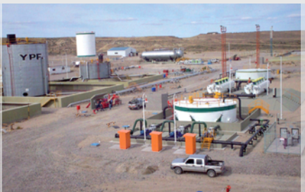
Planta de Proceso Cañadón Escondido 10. Yacimiento Cañadón Escondido. Santa Cruz - YPF.
