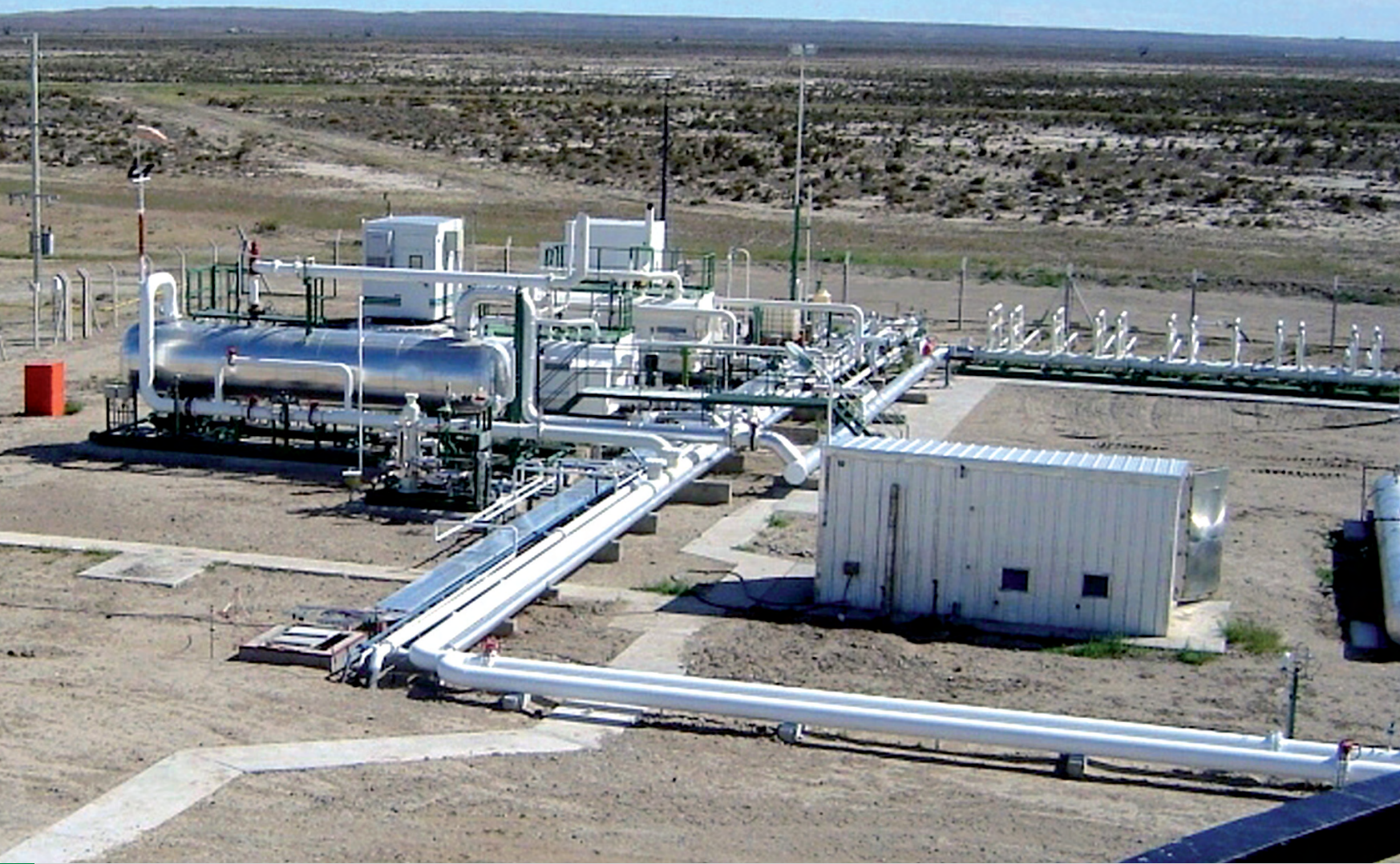
Baterías de Petróleo / Cerro Dragón - Chubut / PAN AMERICAN ENERGY
