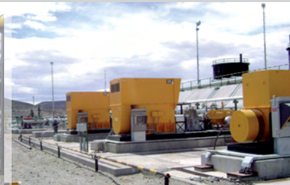
Planta de Inyección de Agua Salada Zorro II. Cerro Dragón. Chubut - PAN AMERICAN ENERGY.
