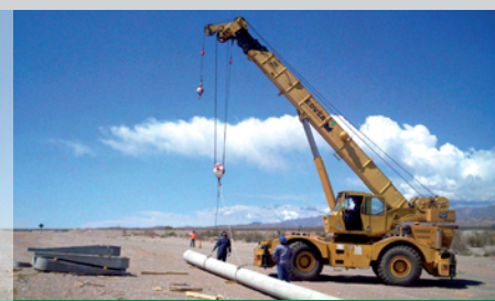
LAT 132 kV GUALCAMAYO. San Juan - MINAS ARGENTINAS
