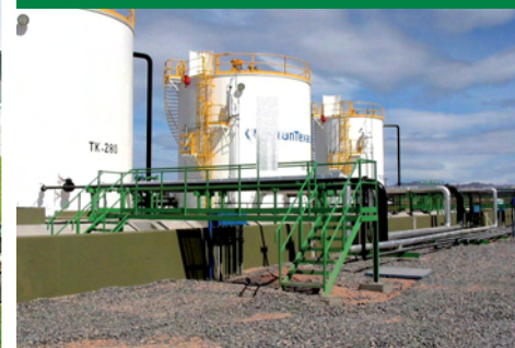
Batería ET 8. El Trapial. Neuquén - CHEVRON SAN JORGE S.R.L.
