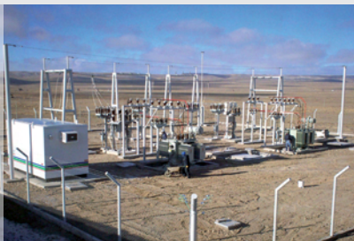
Estaciones Transformadoras de Plantas de Inyección de Agua Salada. Cerro Dragón. Chubut - PAN AMERICAN ENERGY.
