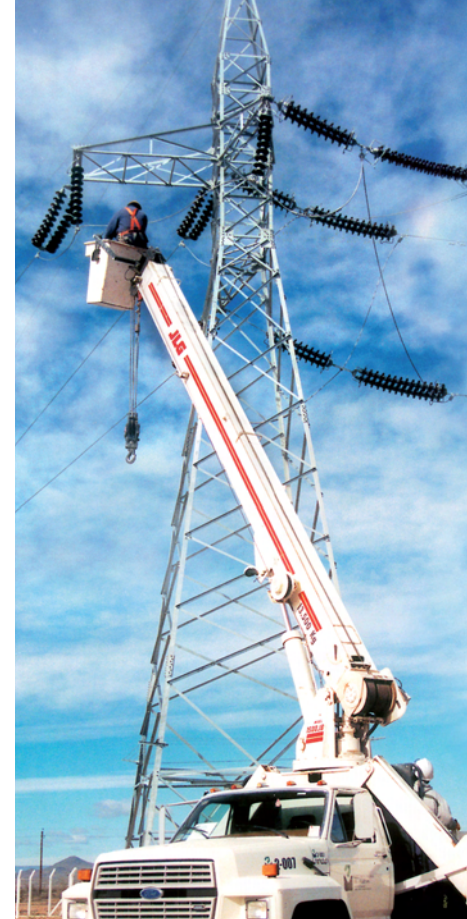
Línea Alta Tensión 132 kV Las Heras. Mina San José. Las Heras. Santa Cruz - MINERA SANTA CRUZ.
