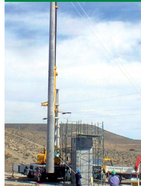
Línea Alta Tensión 132 kV Meseta 14 CG. Cerro Dragón. Chubut - PAN AMERICAN ENERGY.
