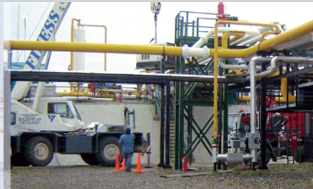
Planta de Gas San Sebastián 4. Bahía San Sebastián. Tierra del Fuego - APACHE.
