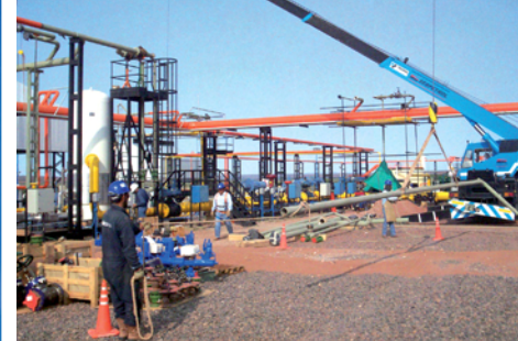
Estación Compresora N 14. Loma de la Lata. Neuquén - REPSOL YPF.
