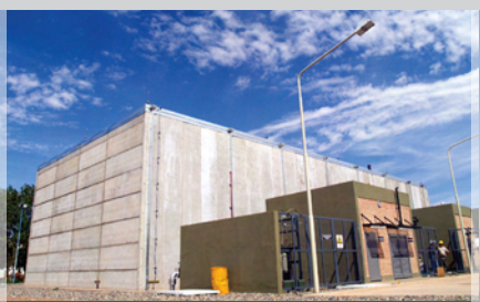
Centro de Distribución 33/13,2 kV. Loma de la Lata - REPSOL YPF.
